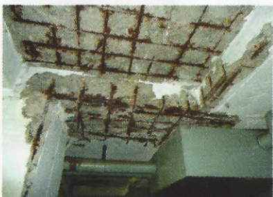
Corrosão de armaduras em laje, viga e pilar em estágio avançado no teto do subsolo, com deslocamento do concreto
