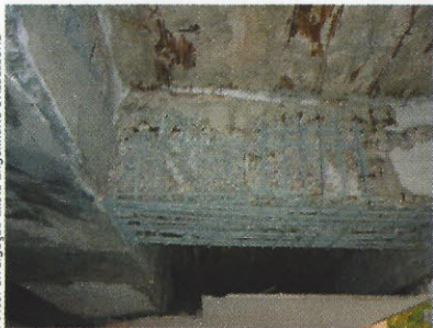
Escarificação profunda na face inferior e lateral da viga de transição da garagem de edifício
